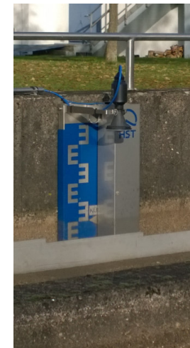
RÜB Lebach - Messstelle
