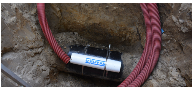
Erdvergrabene Messungen zur kostengünstigen Nachrüstung im Leitungsnetz Quelle: NIVUS
